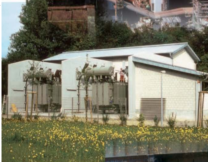
Application Système public de distribution d'électricité
