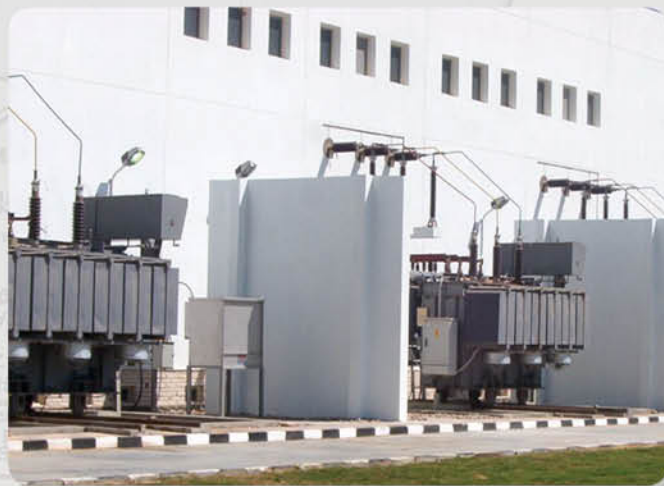
Centrale électrique de la village intelligente
