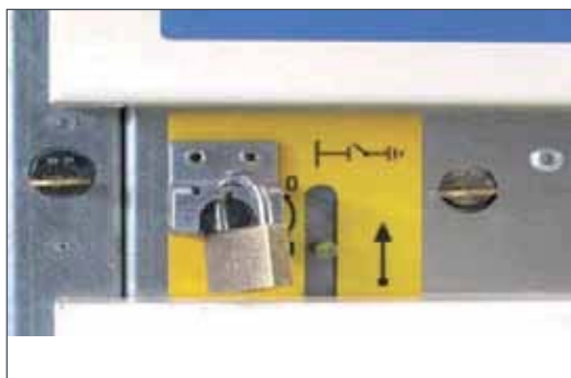
Fig. 10.9 Condamnation du sectionneur de mise à la terre par cadenas
