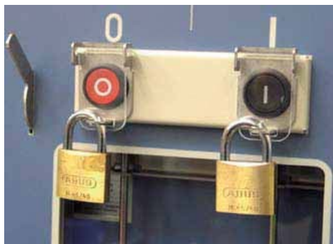
Fig. 10.8 Les volets de recouvrement sur le bouton- poussoir ENCLENCHE/DECLENCHE pour le disjoncteur peuvent être verrouillés au moyen d'un cadenas (en option)
